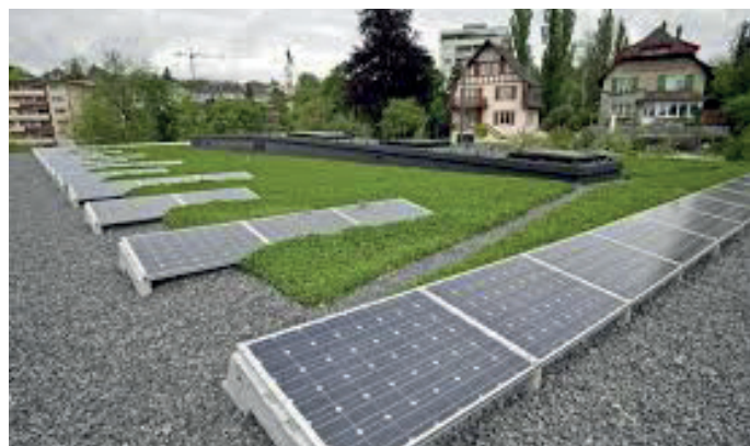
Photo de panneaux photovoltaïques installés sur une toiture (source : Pierre LE TULZO).
